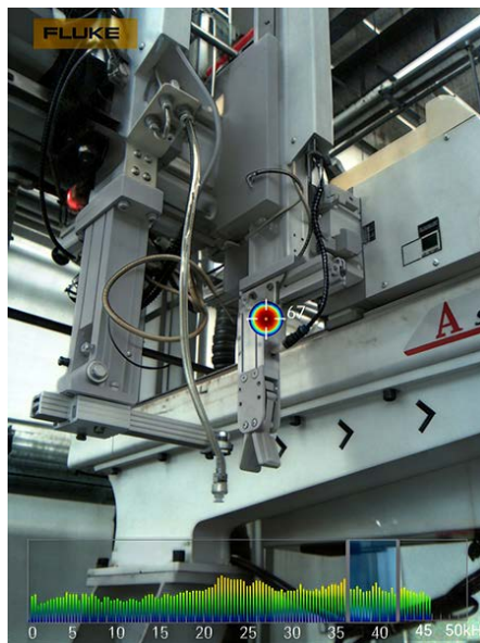
Detección de fugas de aire comprimido en máquinas industriales
